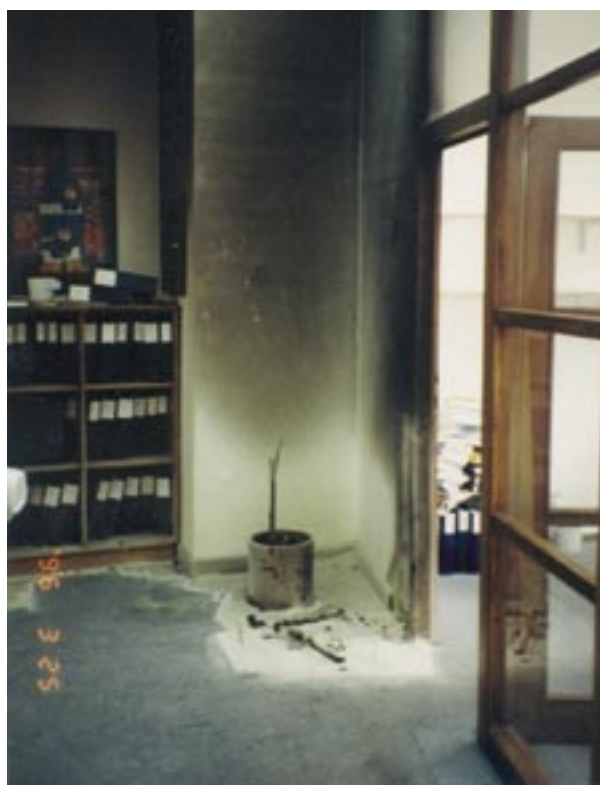
Obrázek 2-2. Stav po požáru, způsobeném odhozením nedopalku do koše. Office after the fire, caused by a cigaret thrown into waste basket.
